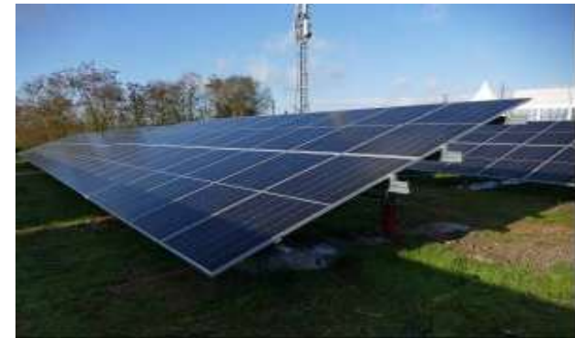
Centrale photovoltaïque : chemins des sources à Montigny les Metz
