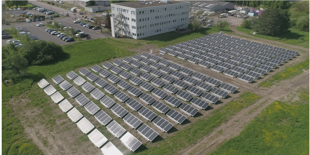
Centrale photovoltaïque : 11 rue Teilhard de Chardin à Metz
